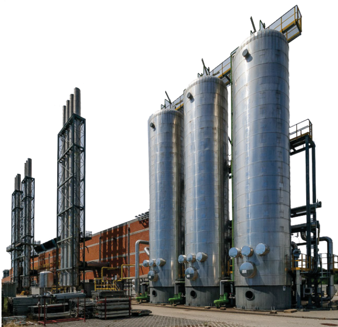
Accumuli termici delle Centrali Canavese e Famagosta _ © Archivio fotografico Boutique creativa
