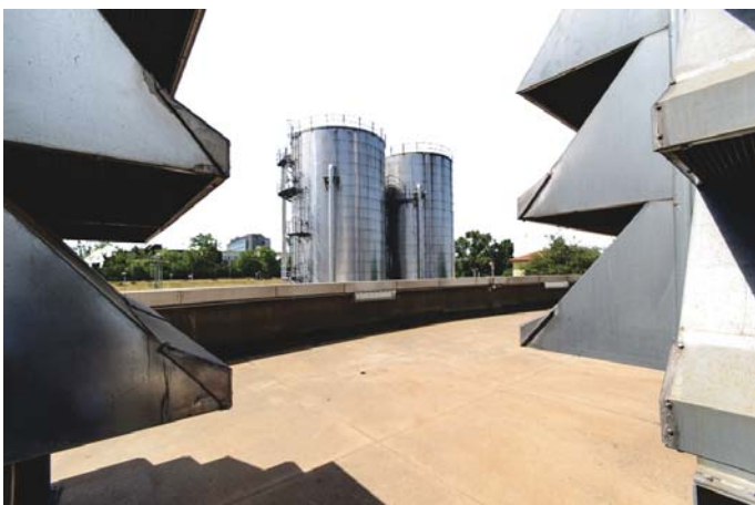
Accumuli termici delle Centrali Canavese e Famagosta _ © Archivio fotografico Boutique creativa
