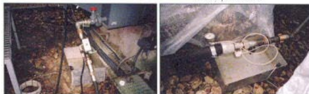
Les vannes d'entrée et de sortie du système sur le transformateur. En cas de fuite il y a une alarme transmise par GSM.
