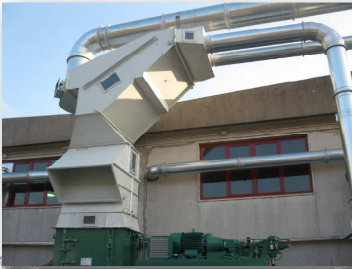
Separatore statico con doppio ingresso, valvole di non ritorno e by-pass.
