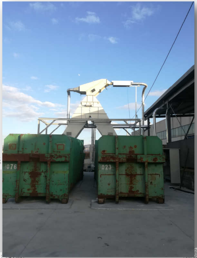
Impianto aspirazione rifiuti carta con separatore statico su pressa, by-pass pneumatico e filtro abbattimento polveri.
