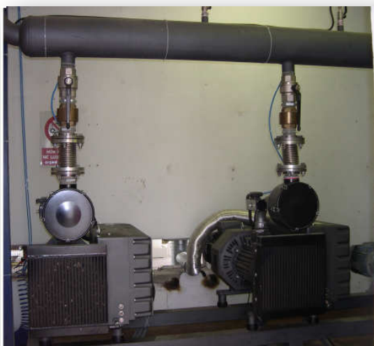
Stazione soffiante centralizzata a 1,5bar.
