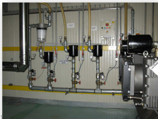
Stazione di vuoto centralizzata.
