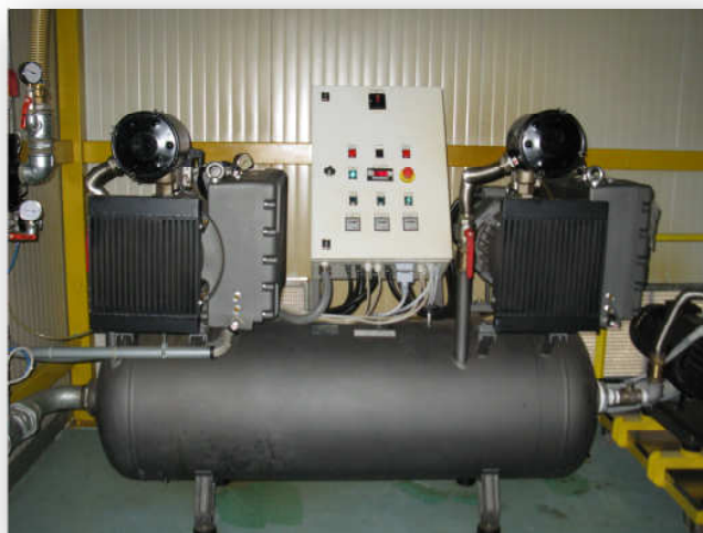
Stazione di vuoto o soffio centralizzato con doppia pompa su serbatoio.
