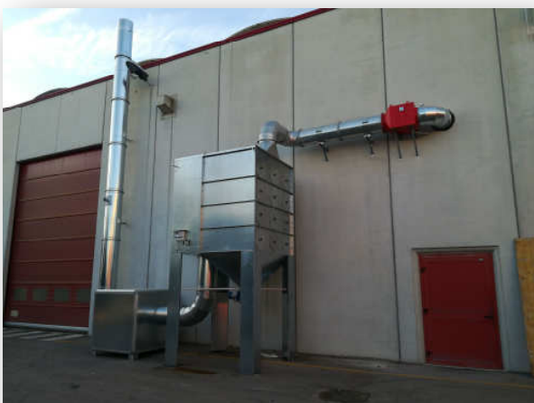
Filtro abbattimento polveri autopulente a cartucce orizzontali con valvola di non ritorno e ventilatore insonorizzato.
