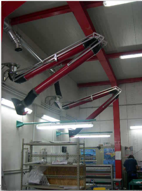
Bracci aspiranti per fumi di saldatura.
