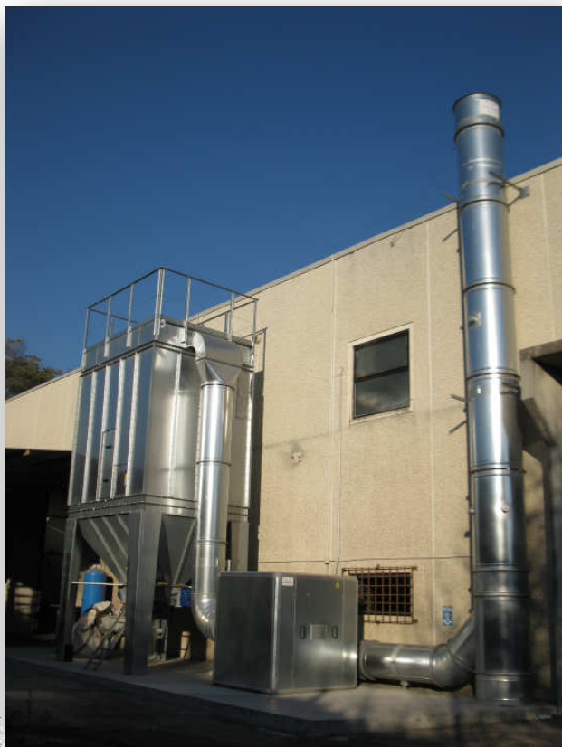
Filtro a maniche da 20.000m 3 /h con ventilatore insonorizzato e camino espulsione aria.
