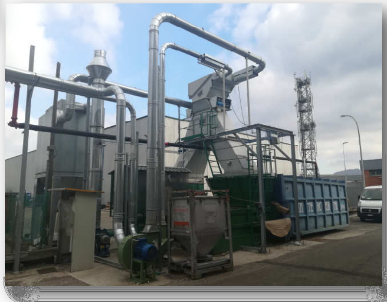
Impianto con by-pass pneumatico per scaricare su pressa legaballe o pressa con compattatore in caso di guasto.
