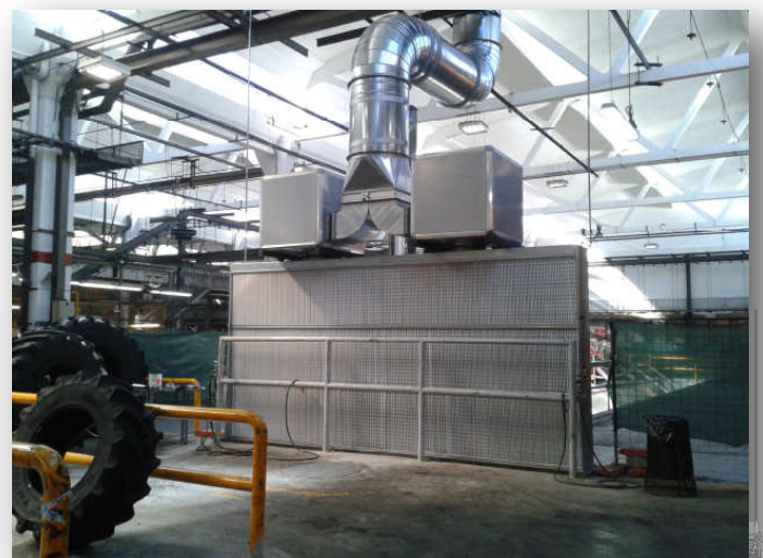
Parete aspirante per fumi e polveri con ventilatori cassonati insonorizzati.
