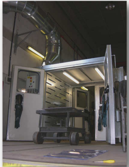
Cabina insonorizzata con parete aspirante per soffia- gio motori.
