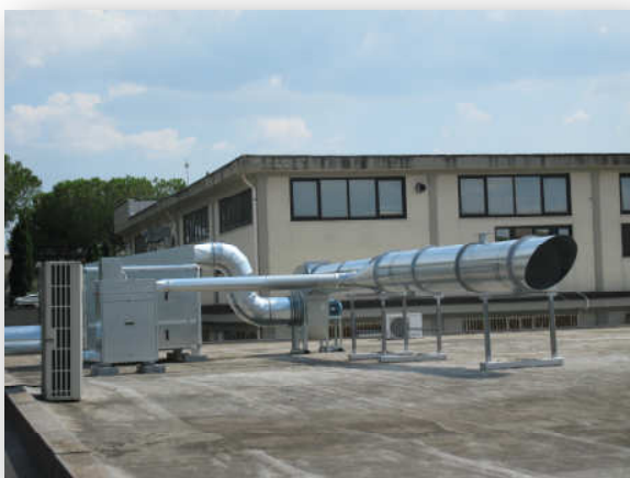
Impianto abbattimento odori e vapori a carboni attivi.
