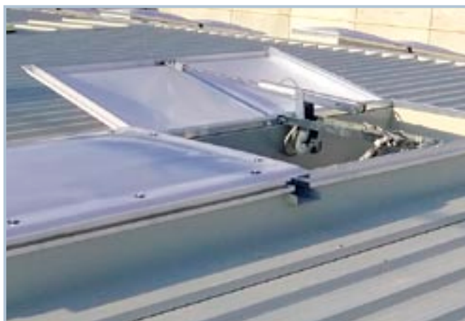
Evacuatore naturale di fumo e calore
