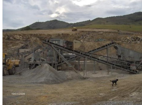
AUTOMATIZACION PLANTA SALITRE BLANCO VILLETA
