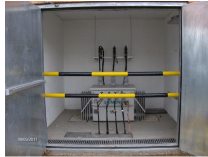
SUBESTACION RESERVA DE TIBABUYES
