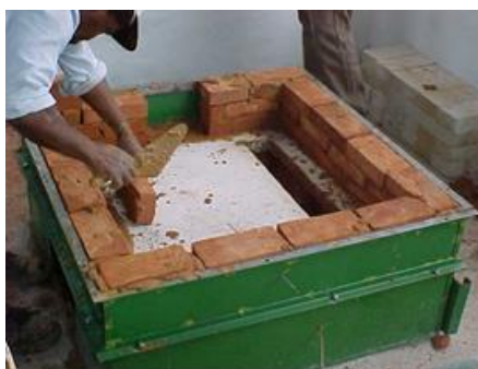
Figura 223 - Revestimento interno dos módulos que compõem a fornalha.
