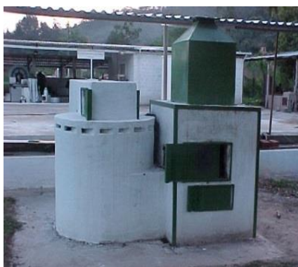
Figura 212 - Fornalha a carvão vegetal com depósito de carvão em chapa metálica.
