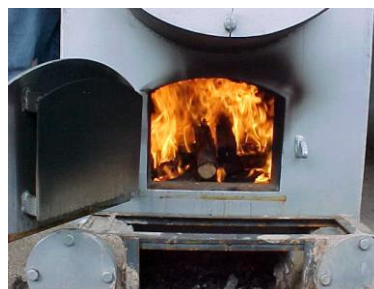
Figura 180 - Câmara de combustão da fornalha de uma pequena caldeira.
