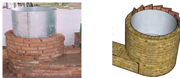
Figura 247 - Construção do ciclone, mostrando a forma metálica para facilitar o assentamento e alinhamento dos tijolos e a formação da coroa com aberturas tangenciais para entrada de ar.
