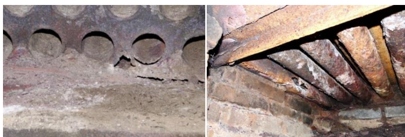
Figura 177 - Detalhes de um trocador de calor (ar/ar) seriamente danificado pelo processo de corrosão.
