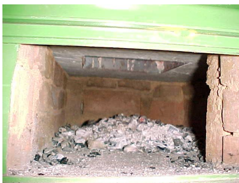
Figura 233 - Compartimento cinzeiro, onde é mostrada a abertura na laje da câmara de combustão por onde caem as cinzas.
