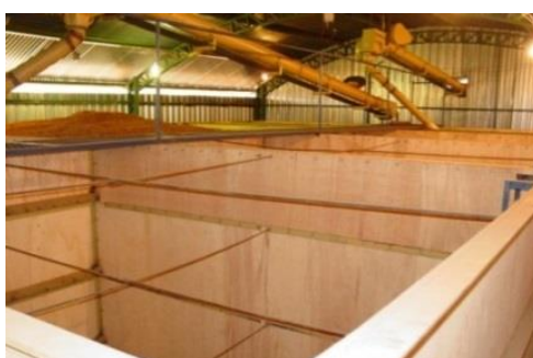
Figura 158 - Tulhas com sistema de ventilação para secagem complementar do café pergaminho.
