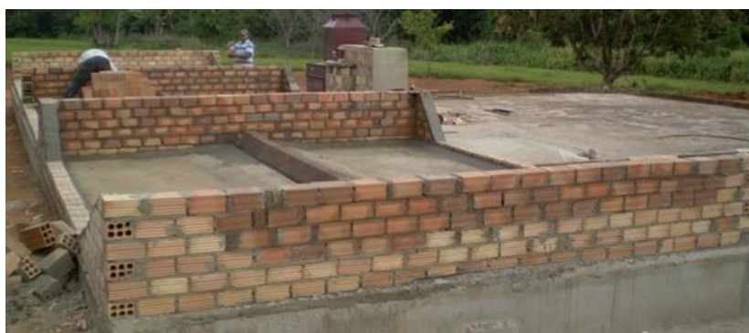
Figura 76 - Detalhes do piso concretado e construção das divisórias em alvenaria de tijolos e posicionamento da calha de perfurada.
