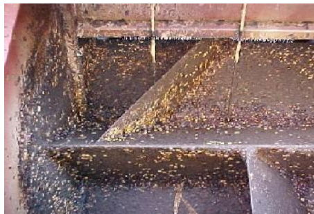
Figura 133 - A mucilagem e os resíduos do café úmido causam a obstrução dos furos do distribuidor de ar quente, que impede a passagem do fluxo de ar de secagem.
