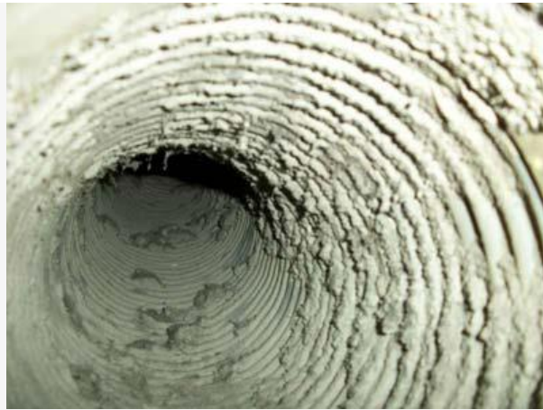
Interno canale dell'aria
